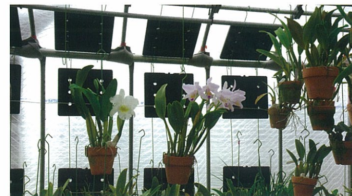
ラン温室に取り付けられたエネバンク
